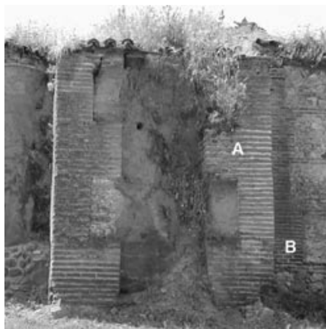
Fig. 3- Sector antiguo (s.IX) de la muralla localizado cerca de la Cartuja (s.XVII). Aunque los tapiales aparecen muy deteriorados, los ladrillos dominantes son del tipo I (A), habiendo zonas donde se han reconocido ladrillos del tipo IV (B).
