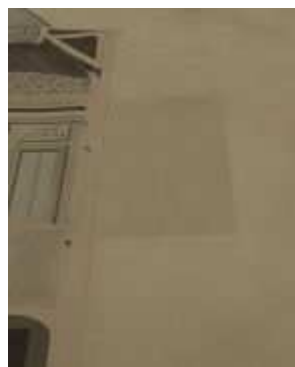
Detalles de las catas de suciedad.
